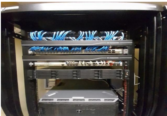
Imagem 105 - Servidor Storage Instalado no Rack da Sala dos Servidores
